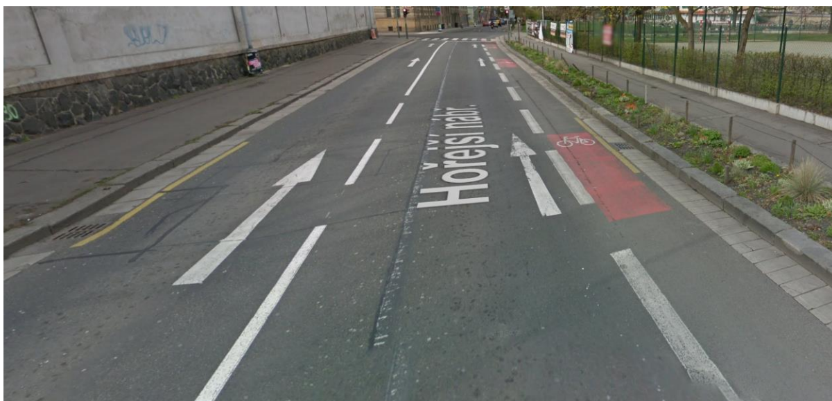
Obrázek č. 30 Nižší kvalita dopravního značení na úseku 756, Hořejší nábřeží.
